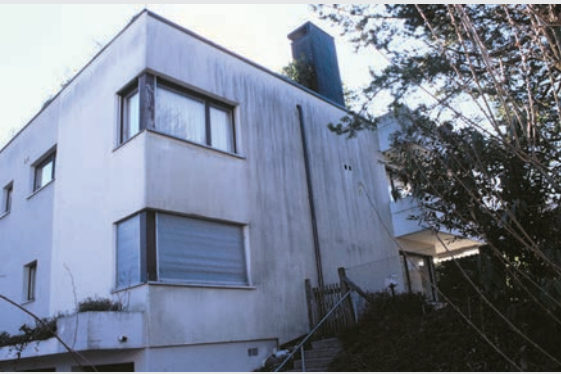
Algenbewuchs an Nordfassade
